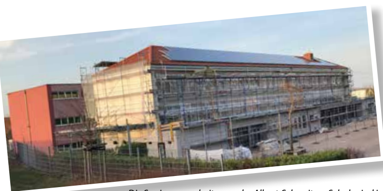
Die Sanierungsarbeiten an der Albert-Schweitzer-Schule sind in vollem Gange, auch hierfür hat sich die SPD-Stadtratsfraktion stark gemacht. Doch wird der Platz reichen?
